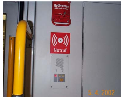
Notrufsäule in einer Niederflur-Straßenbahn (Quelle: Rheinbahn)
