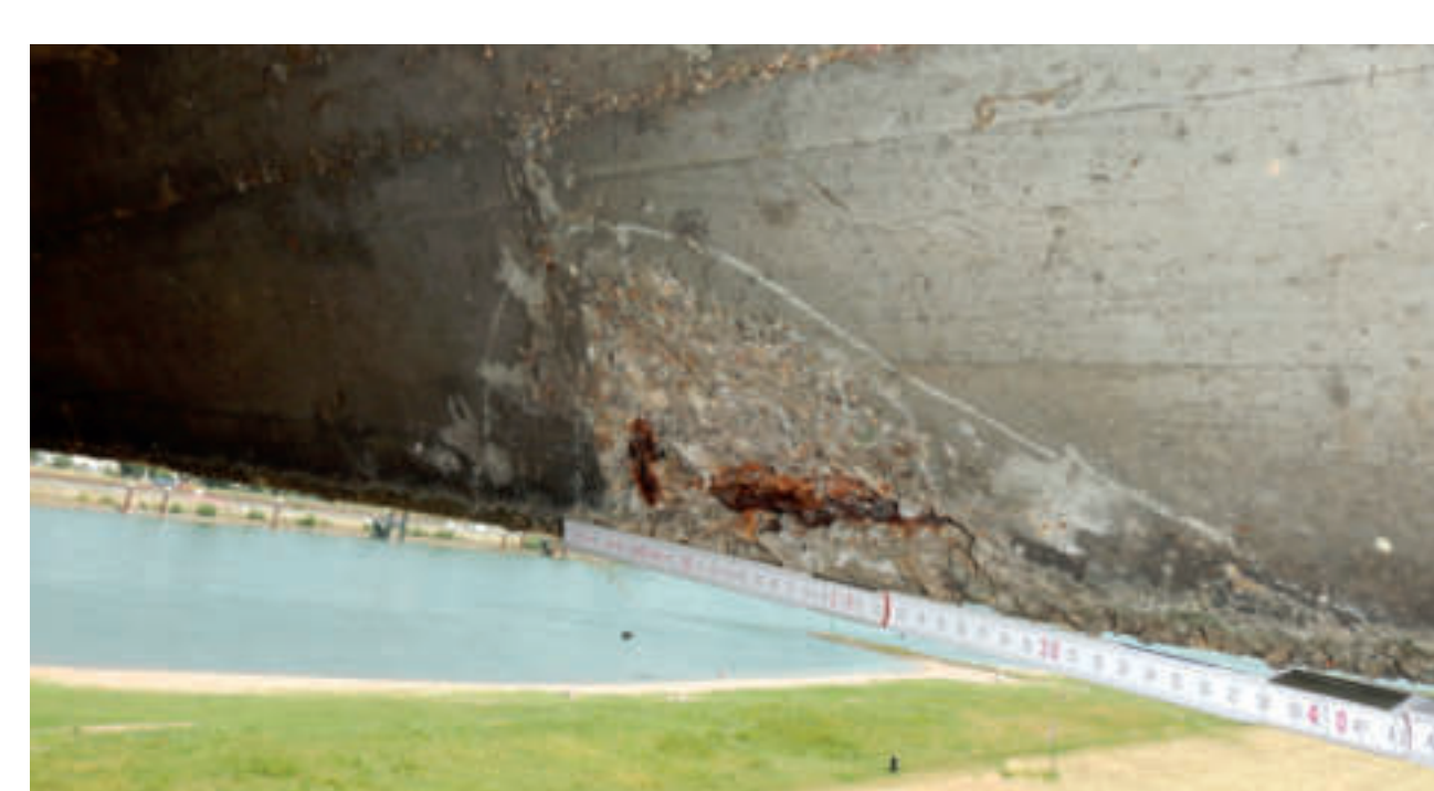
Betonabplatzungen und freiliegende Bewehrung an der Unterseite Spannbeton-Verbundplatte
