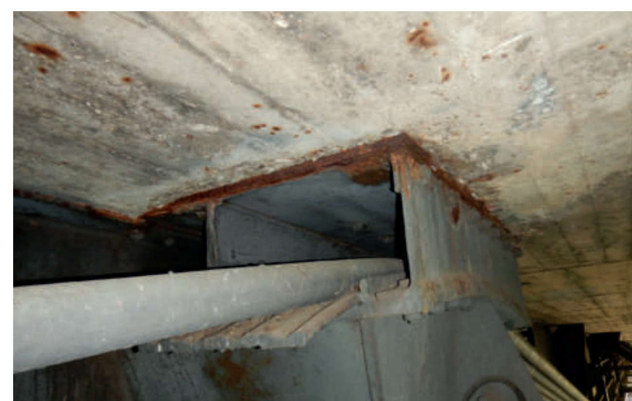
Korrosionsschäden an der Umlenkung der Unterspannung
