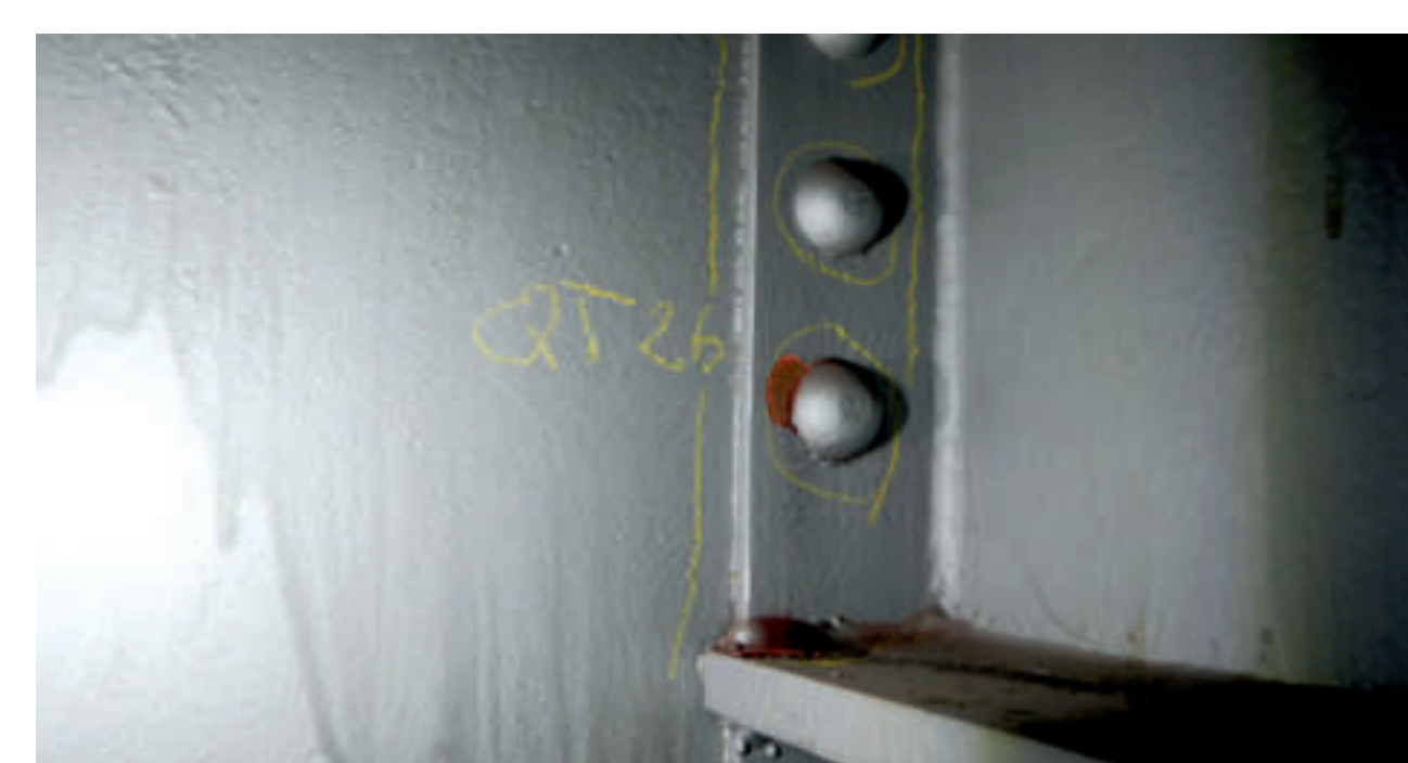
Loose Niete, die sich unter Belastung verschiebt. Das Foto stammt aus dem Längsträger.
