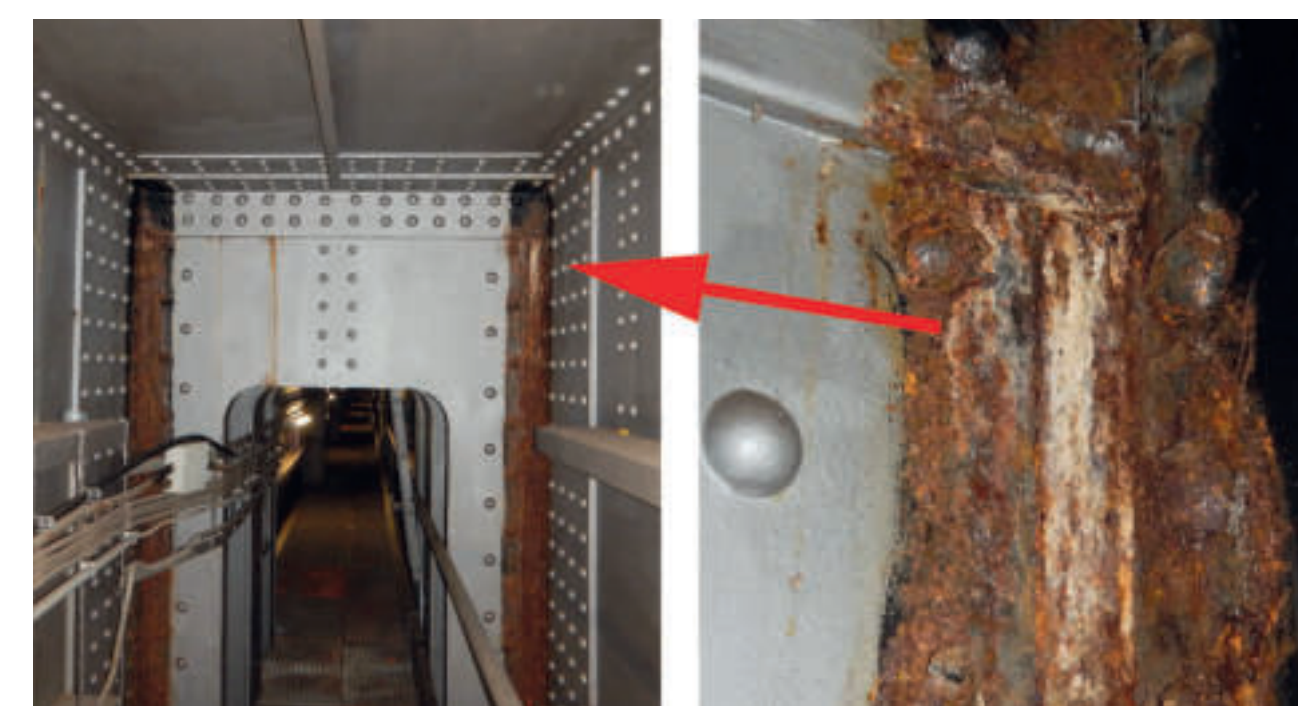
Korrosionsschäden im Bereich des Pylonstiels. Zu sehen ist das Querschott, welches unterhalb des Pylonstiels liegt.
