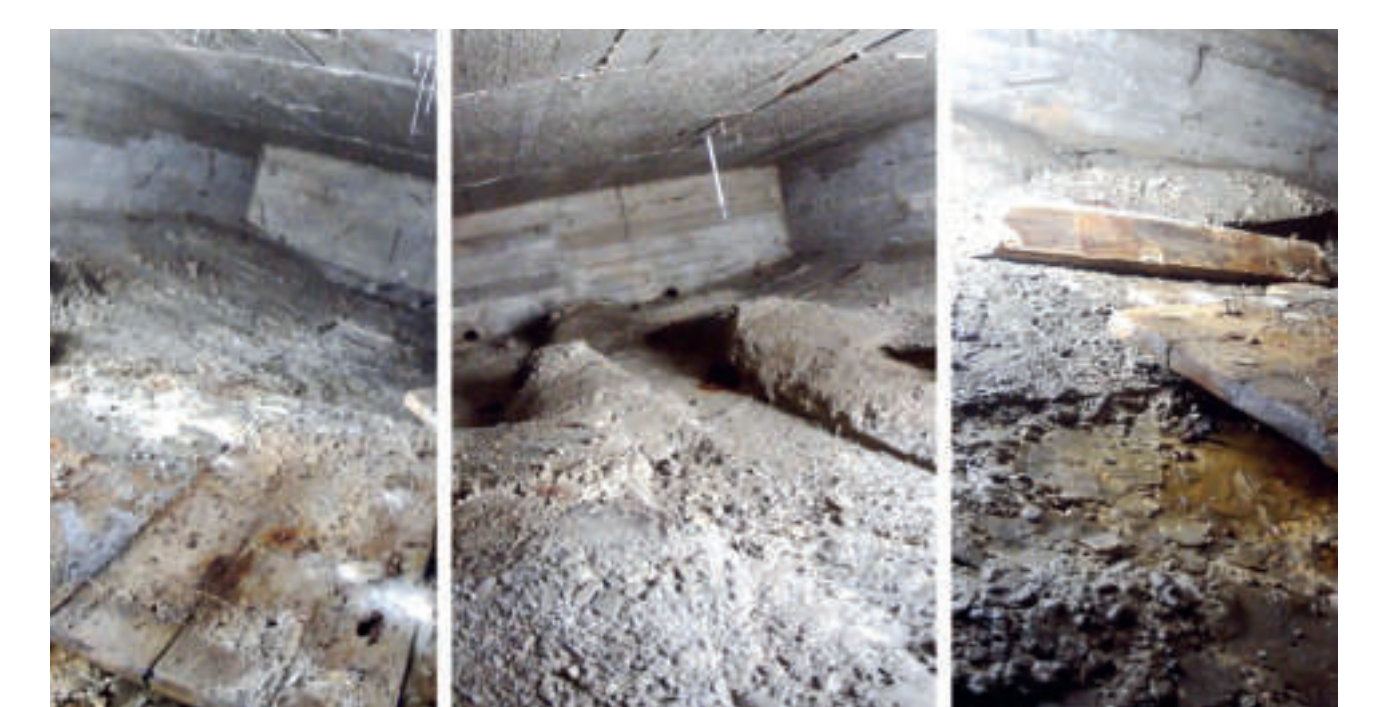
Blick in den Hohlkörper des Überbaus mittels Endoskopie. Zu sehen sind Stalaktiten infolge Undichtigkeiten sowie eine Pfützenbildung. Die vorhandenen Bretter stammen aus der Bauphase und können mangels Zutritts zum Hohlkörper nicht entfernt werden.
