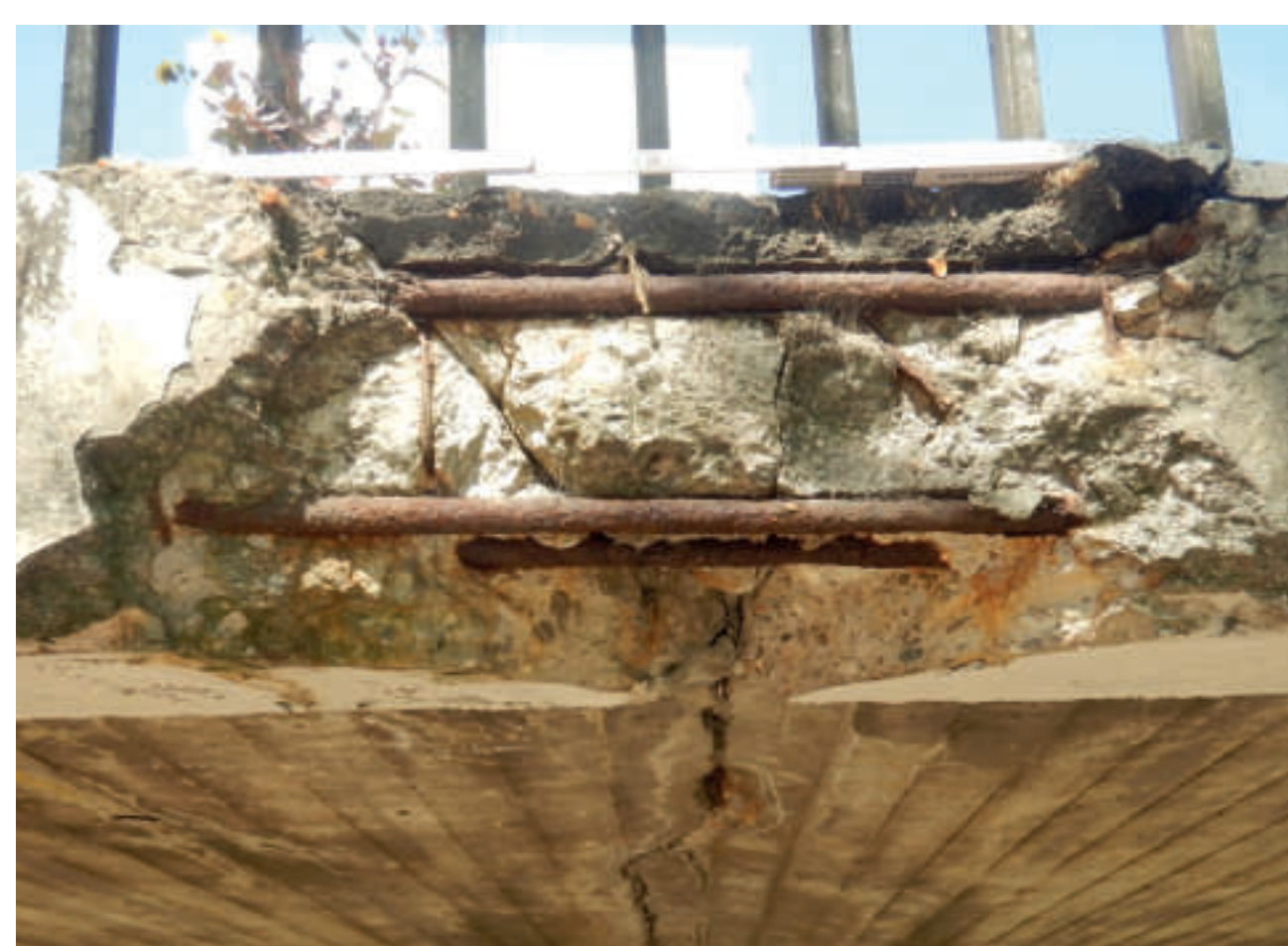
Betonausbrüche in der Brückenkappe mit freiliegender und korrodierter Bewehrung.
