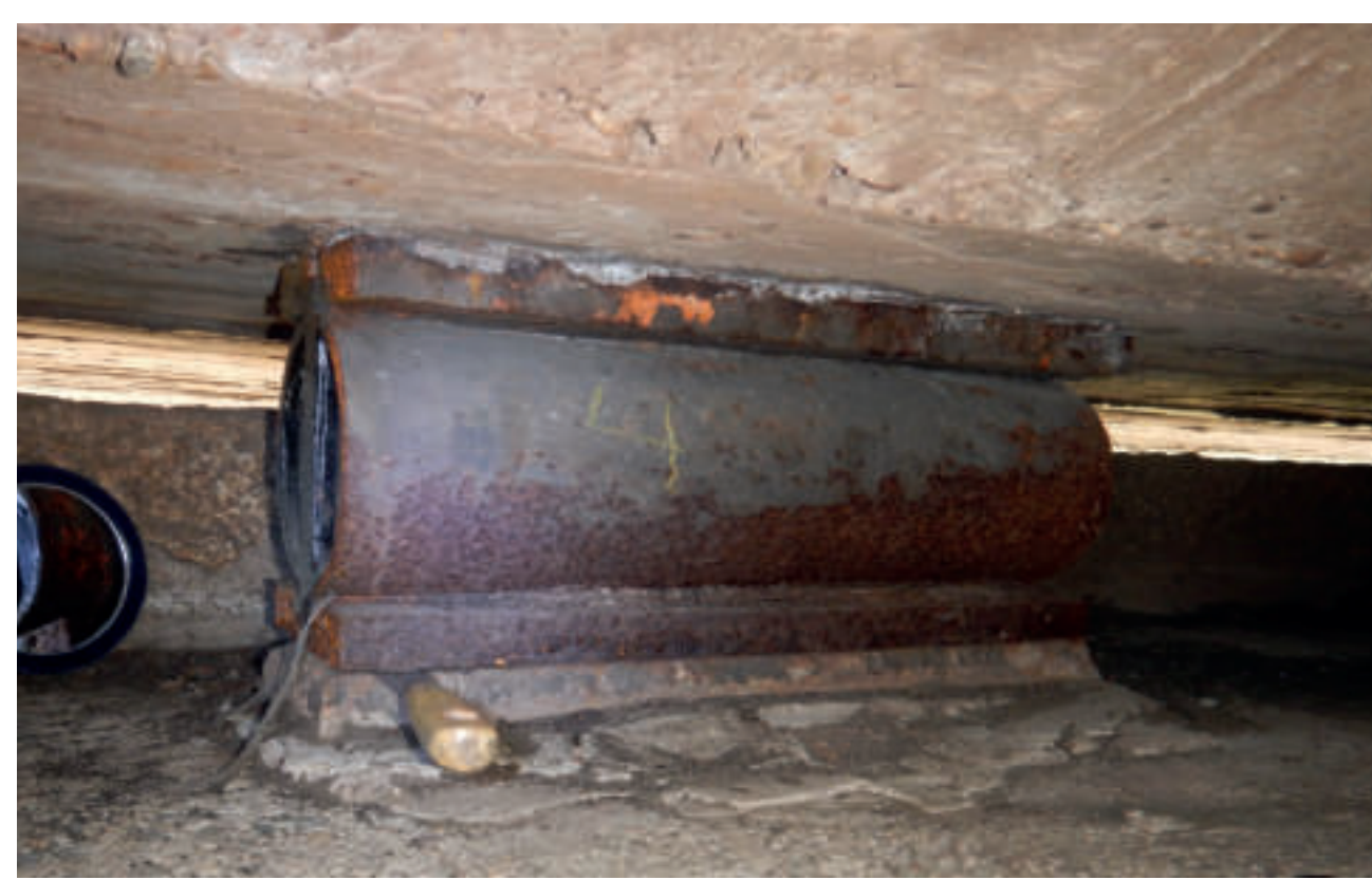
Korrosionsschäden am Rollenlager
