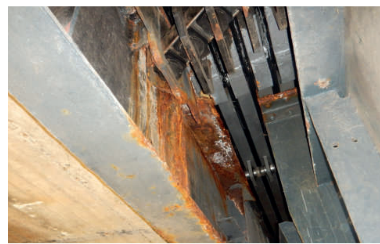
Korrosionsschäden an der Übergangskonstruktion (ÜKO)
