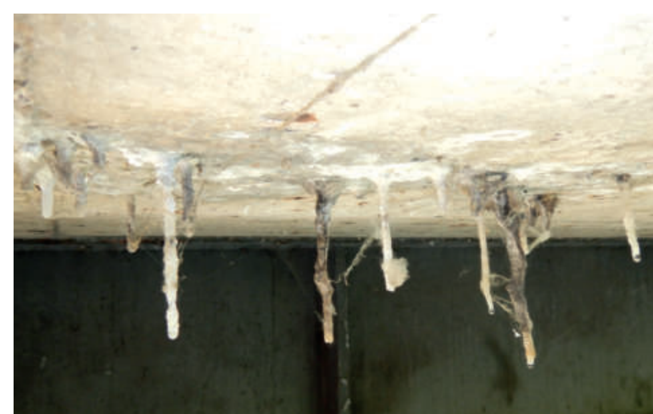
Stalaktitenbildung in Folge von Undichtigkeiten an der Unterseite Spannbeton-Verbundplatte
