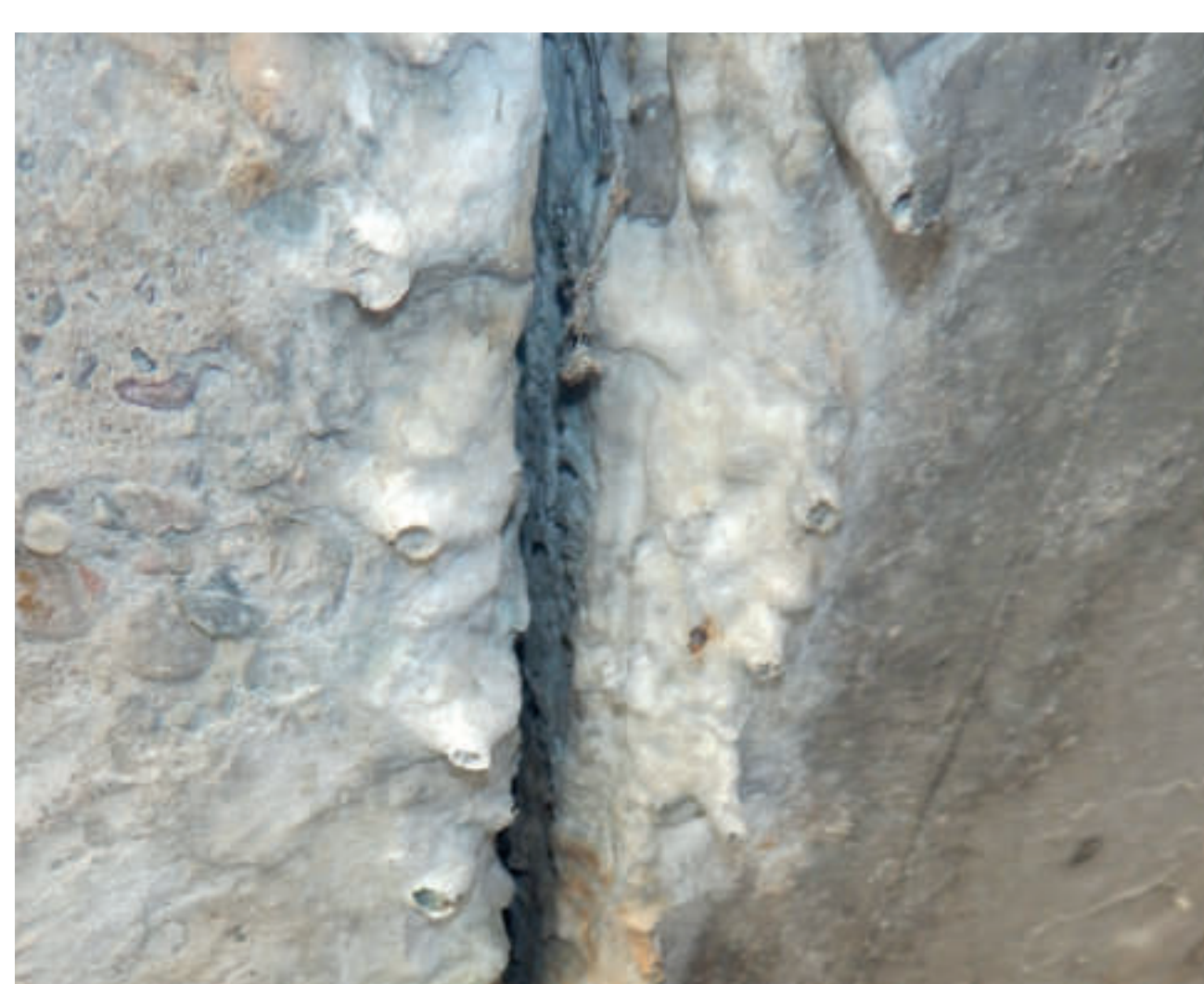
Stalaktitenbildung infolge Undichtigkeiten an der Unterseite der Kragarmplatte im Bereich einer Bauwerksfuge.
