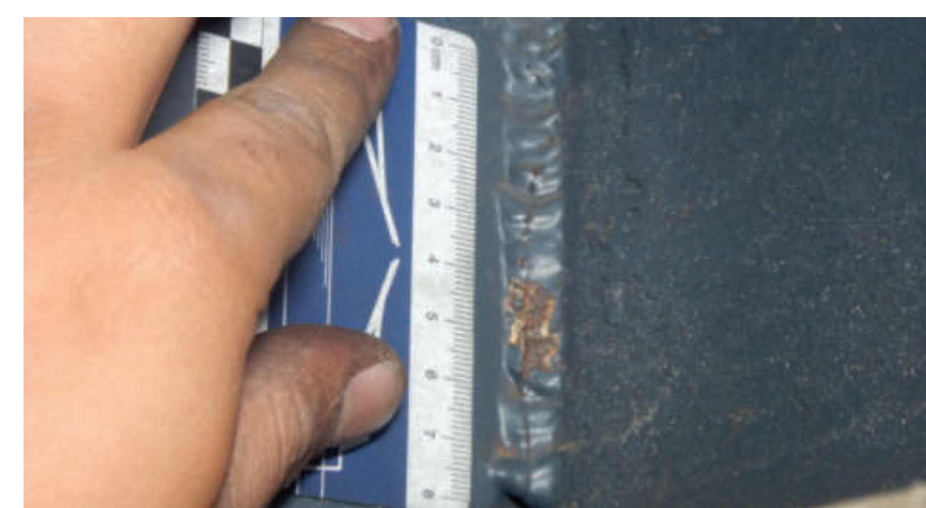
Rissbildung innerhalb einer Schweißnaht, Anschluss Quer- und Längsträger
