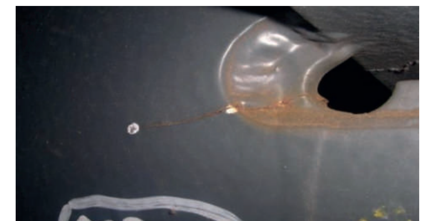
Rissbildung im Querträger. Die 2 weißen Punkte zeigen das Ende der Risswurzel zu unterschiedlichen Zeitpunkten. Hieraus wird ersichtlich, dass der Riss seit der vorangegangenen Bauwerksprüfung länger wurde.
