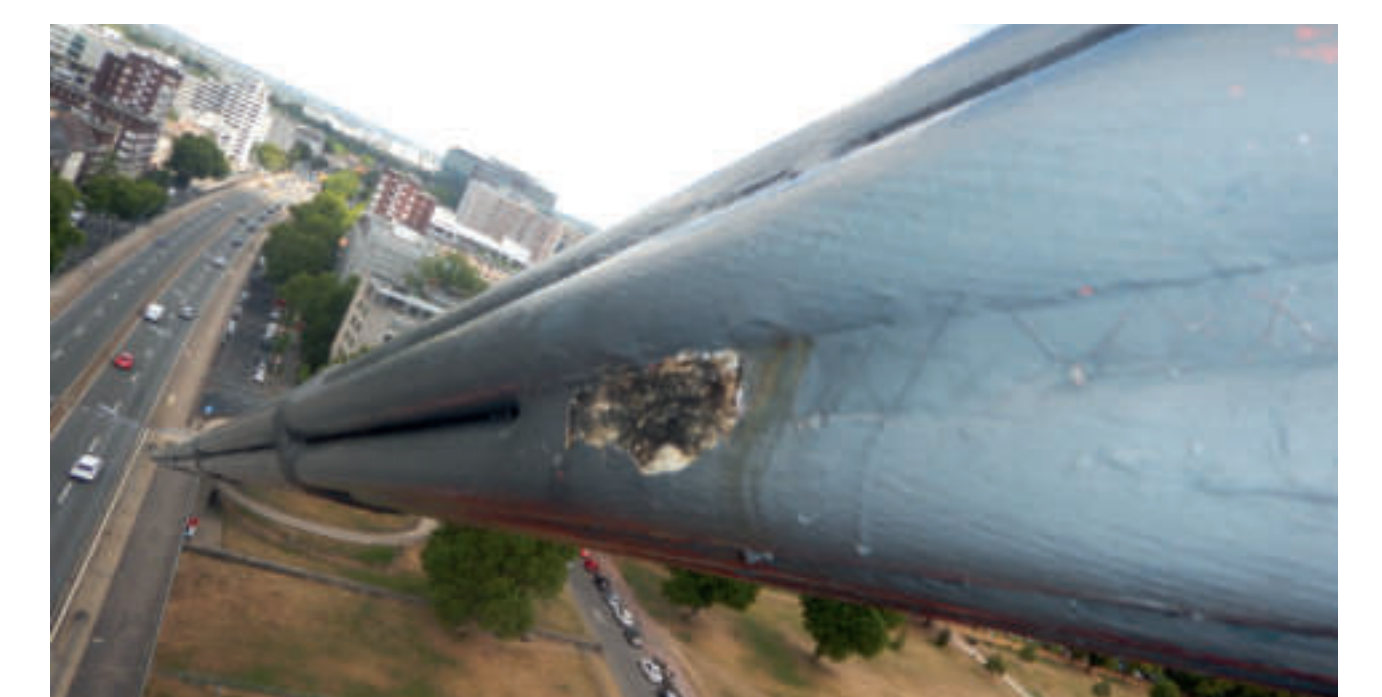
Korrosionsschäden am Tragkabel
