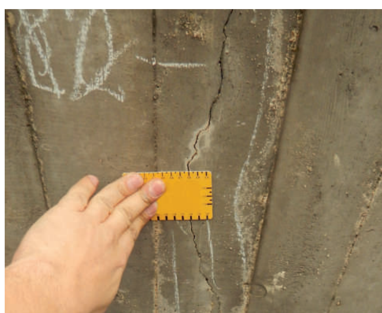
Rissbildung an der Unterseite der Kragarmplatte mit freiliegender Bewehrung.
