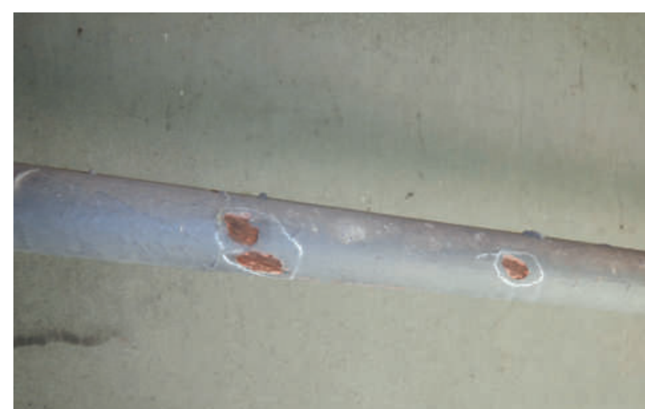
Korrosionsschäden an einem der Tragseile
