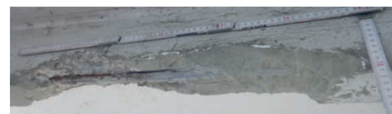
Betonabplatzungen und freiliegende Bewehrung an der Unterseite der Kragarmplatte aus Stahlbeton
