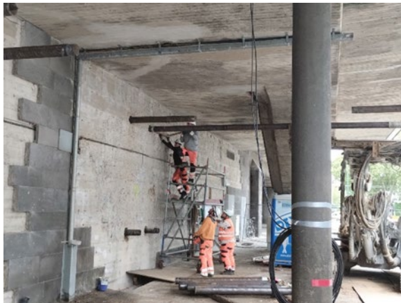
Rampe: Zugbandertüchtigung ➤ Weitere Schäden festgestellt
