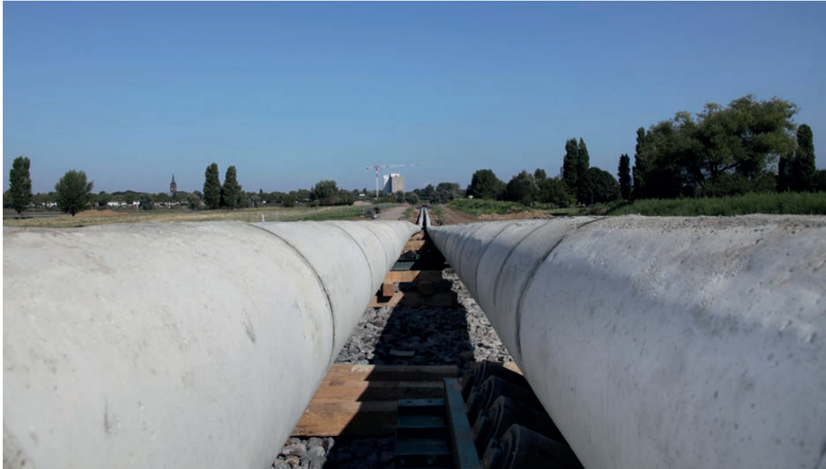
Fernwärmeleitung in Richtung Düsseldorf-Heerdt
