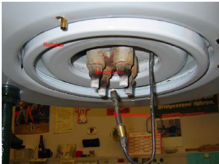
Bild 3: Gasaustritt an der Leuchtenunterseite
